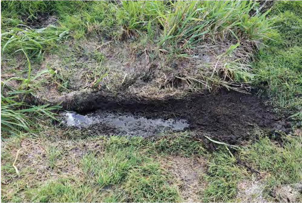
Abbildung 11: Anfahrtschwierigkeiten bei dem von der Oberfläche her durch Niederschläge vernässten Mulm
