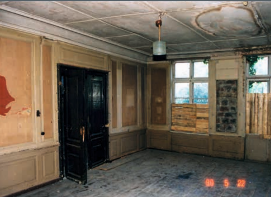
Die 1989 leergezogenen Gebäude befanden sich in einem katastrophalen Zustand.
