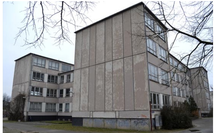
Der alte Schulkomplex des Goethe-Gymnasiums hat bald ausgedient. 2013 sollen die Bauarbeiten für den Neubau beginnen.
