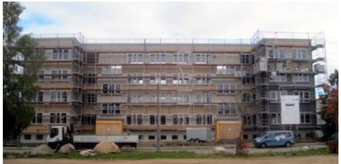
Neben der Grundschule Lankow und dem Goethe Gymnasium fließt im kommenden Jahr auch weiteres Geld in die Sanierung der Grundschule Mueßler Berg. Insgesamt kostet die Baumaßnahme 4,2 Millionen Euro.
